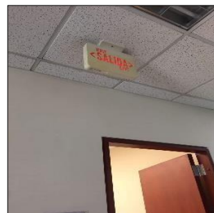
Señalización de evacuación.
