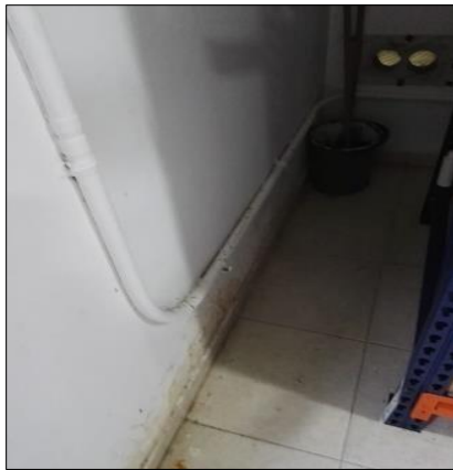
Muestra de humedad pared CACOM-6
