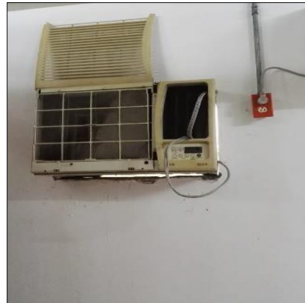
Aire acondicionado averiado CACOM-6
