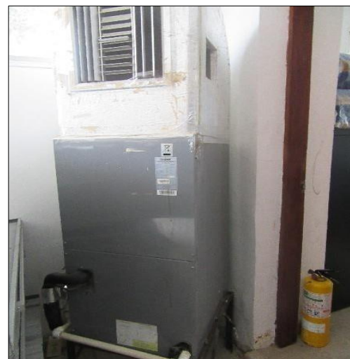
Dispositivo inadecuado para circulación de aire CACOM 3
