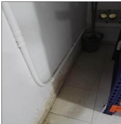
Muestra de humedad pared CACOM-6
