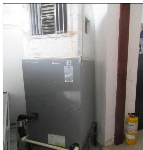
Dispositivo inadecuado para circulación de aire CACOM 3
