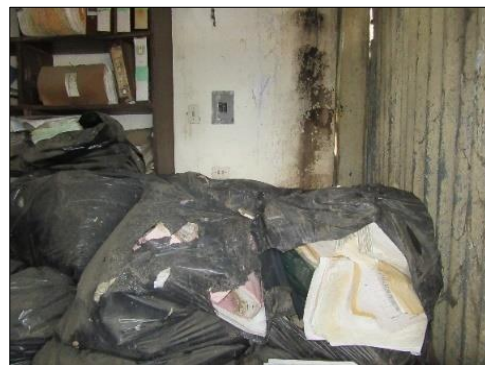
Unidades de almacenamiento CACOM-1
