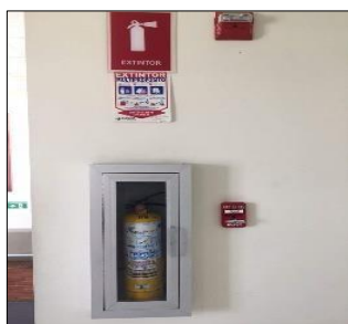
Extintor y alarma manual CATAM
