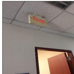
Señalización de evacuación.
